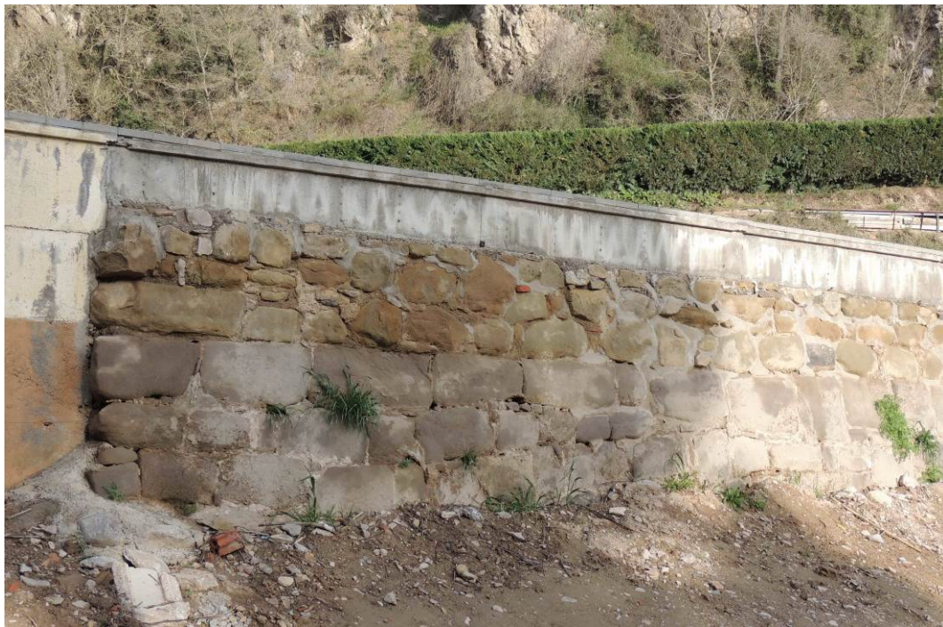
Fotografia 9. Detall dels recreixements del mur de defensa de les avingudes del torrent del Magrà.
